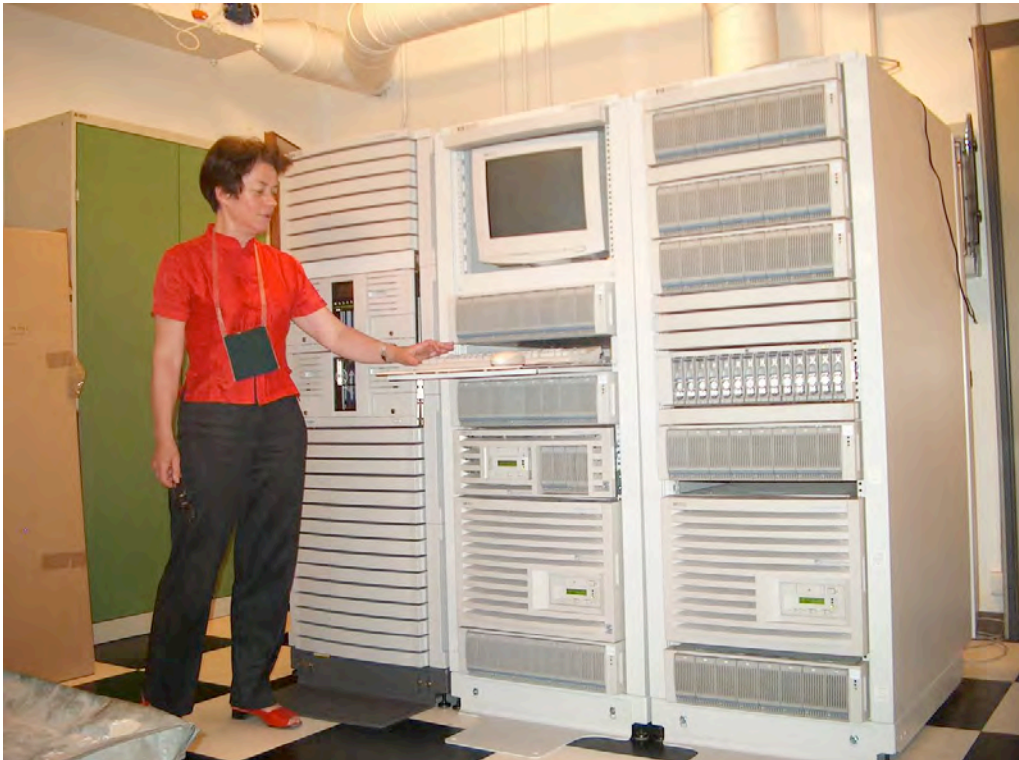
fig. 2 : vue des baies contenant les 3 serveurs installés en 2000 avec 6 téra-octets en ligne
